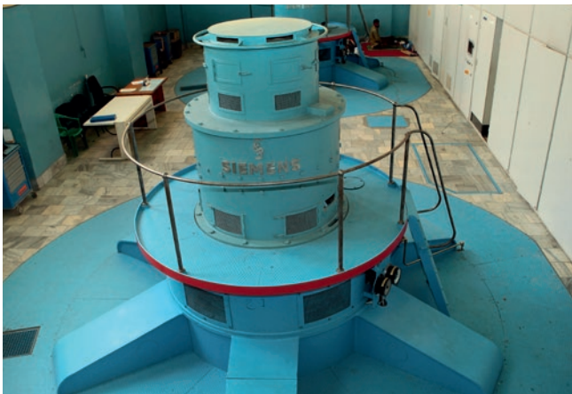
Eine neue Turbine macht Wasserkraft in einem Wasserkraftwerk nutzbar | © KfW
